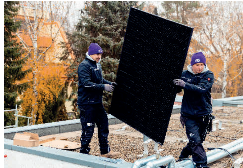
Das Konzept von 1Komma5° besteht darin, die energetische Sanierung von Häusern herstellerübergreifend zu vernetzen. Foto: 1KOMMA5°
