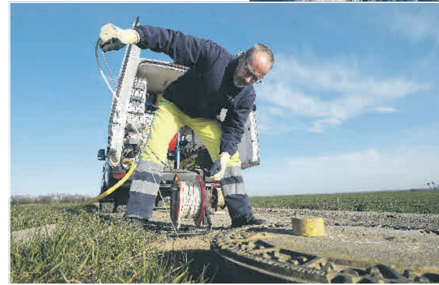
Grundwassermessung im Rheinischen Braunkohlerevier: Das Grundwasser ist hier auf einer Fläche von 1600 km 2 abgesenkt. Foto: Ertverband
