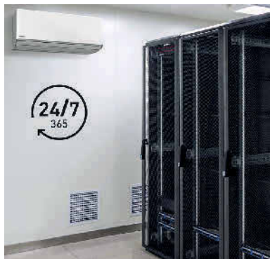
Die Serverraumkühlung wurde mit neuen Fernbedienungen ausgestattet. Foto: Panasonic
