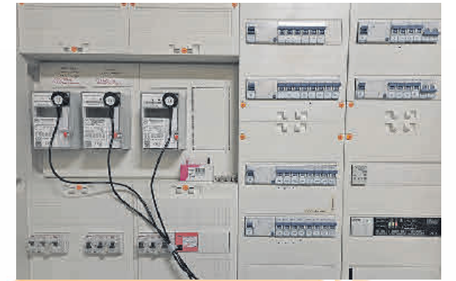
Eine Hausinstallation mit dem Energiemanagementsystem Amperix von Wendeware. Foto: Wendeware
