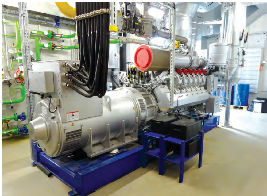
Das Blockheizkraftwerk der Meistermetzgerei Ponnath im oberpfälzischen Kemnath. Bild: Thorsten Meierhofer, Institut für Energietechnik
