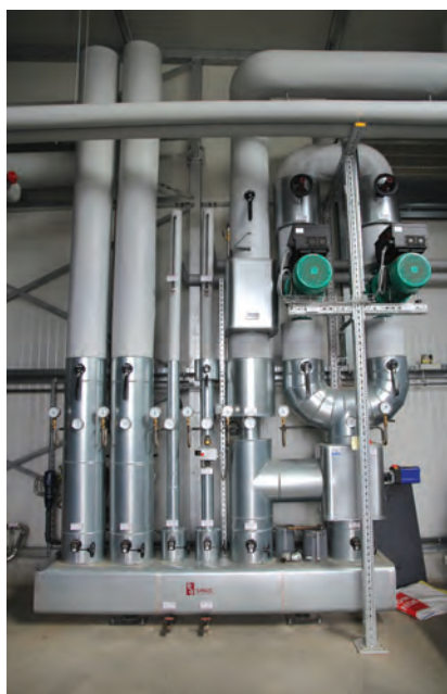
In der Energiezentrale steht der Wärmeverteiler nebst Anschluss der hydraulischen Kreise: Pufferspeicher, Wärmeversorgung der Nebenräume sowie Nahwärmenetz mit entsprechenden Umwälzpumpen. Bild: Bioenergiegenossenschaft Mengsberg
