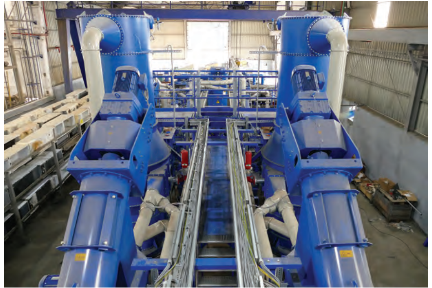
Die Recyclinganlage von der anderen Seite: Zu sehen sind unter anderem die Staub-Filteranlagen in Richtung des Doppel-Entgasungssystems für Polyurethan-Isolierschaum. Bild: Erdwich
