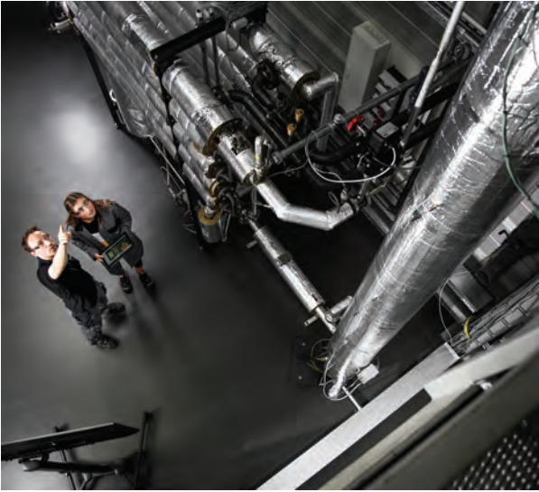
Fraunhofer-Mitarbeiter vor einem neuartigen metallischen Wärmespeicher für die Erzeugung von Prozessdampf für die Industrie. Bild: Fraunhofer Umsicht
