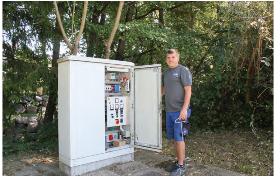
Ronnie Schellin , verantwortlich für die Kläranlage der Gemeinde Murg, steht am Schaltkasten der Pumpstation in Murg-Niederhof. Sie läuft sehr mehrere Monaten störungsfrei. Vorher gab es alle zwei, drei Wochen eine Verstopfung. Bild: Sulzer
