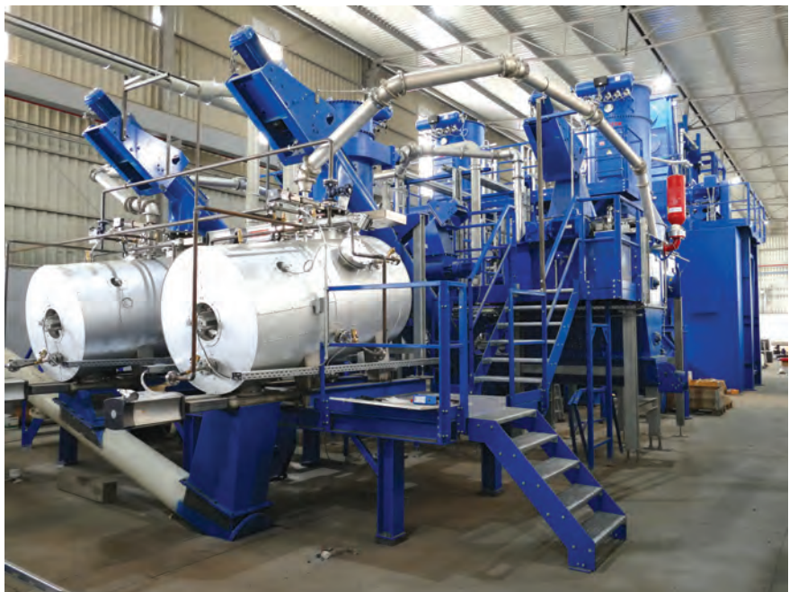
Die Recyclinganlage von der einen Seite: Das Doppel-Entgasungssystem ist gut sichtbar. Bild: Erdwich
