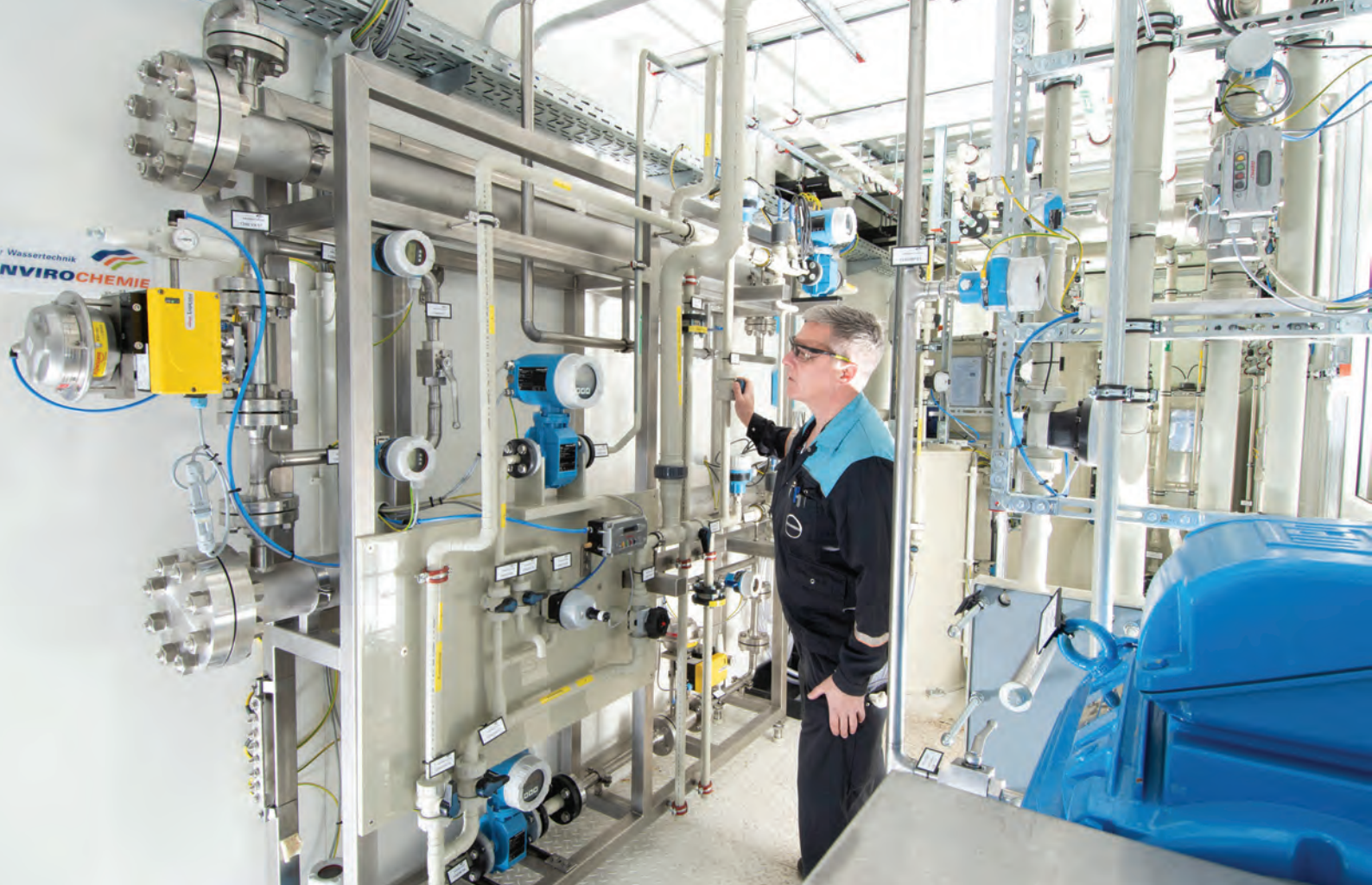
Diese Hochdruckumkehrosmose-Versuchsanlage nutzt Covestro, um die Kochsalz-Konzentration zu erhöhen. Der Projektpartner EnviroChemie hat sie zur Verfügung gestellt. Bild: Covestro
