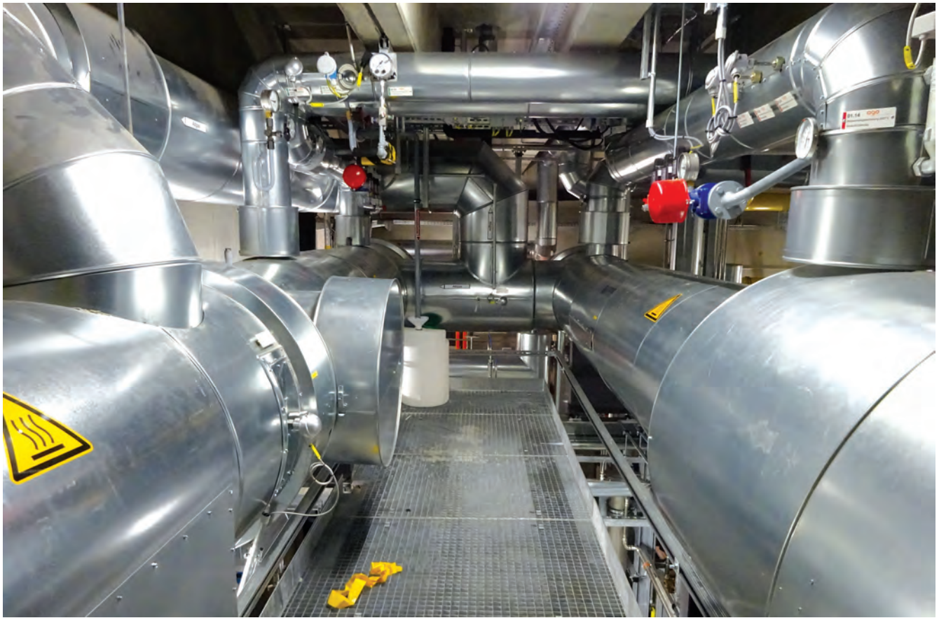
Der Abgas-Wärmetauscher mit Bypässen der Meistermetzgerei in Kemnath . Bild: Thorsten Meierhofer, Institut für Energietechnik
