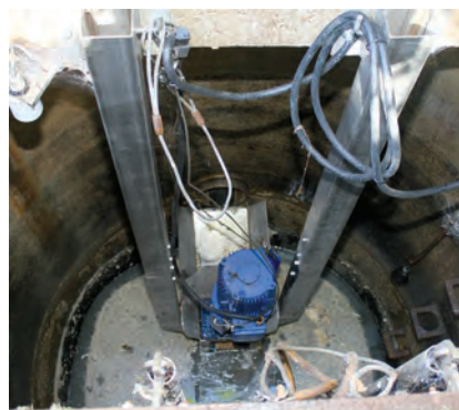
Das „Muffin-Monster“ von Sulzer ist an der Schachtdecke hängend montiert. Der blaue Motor ist sichtbar. Der Zulauf erfolgt über einen offenen Kanal (links). Der Zerkleinerer arbeitet untertags alle 14 Minuten und zwischen 22 und 5 Uhr alle 40 Minuten jeweils 1 Minute. Bild: Sulzer
