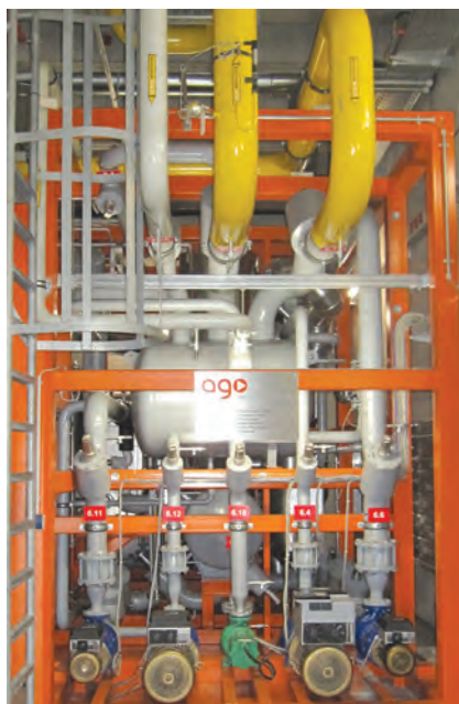
Die Absorptionskälteanlage der Metzgerei. Bild: Thorsten Meierhofer, Institut für Energietechnik
