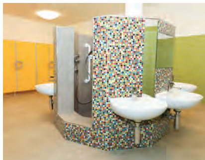
Bild 2: Highlight in den beiden neuen Sanitärräumen ist das Waschrondell, das aus dem Installationssystem Geberit GIS angefertigt wurde. Es ist nach oben hin frei und umfasst acht Waschplätze sowie eine Dusche. Bild: Geberit
