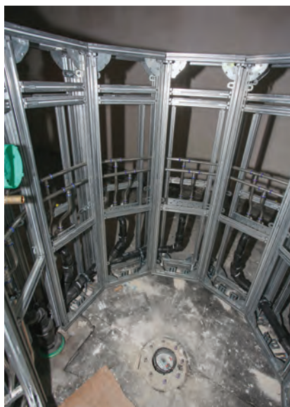
Bild 3: Das Rondell beinhaltet die in Kindertagesstätten vorgeschriebene Dusche. Der Ablauf verläuft mittig in den Boden, die Wasseranschlüsse sind von innen angebracht. Bild: Geberit
