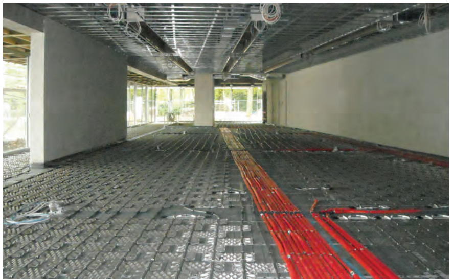
Bild 3: Das PYD-Thermosystem heizt und kühlt im Erweiterungsbau (im Bild das Untergeschoss), im ehemaligen Gärtnerhaus und im Untergeschoss des Haus Wahnfried. Bild: PYD Thermosysteme, Bischofsgrün
