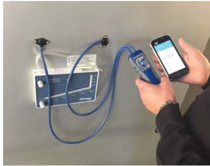
Bild 2: Eine korrekte und professionelle Einregelung der Lüftungsanlage ist unverzichtbar, wenn diese fehlerfrei und effizient arbeiten soll. Bild: Airflow Lufttechnik GmbH
