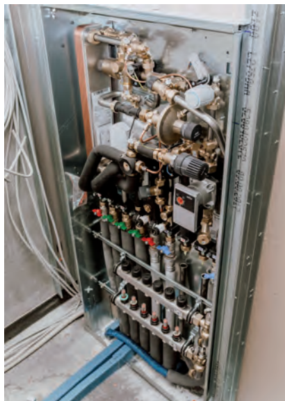
Bild 4: Die Wohnungsstationen sorgen für eine optimale Trinkwasserhygiene. Bild: Uponor
