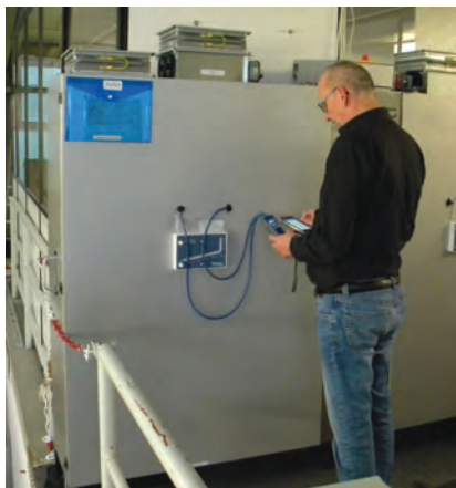
Bild 1: Das Lüftungsgerät wird nach Einbau durch die Installationsfirma oder den Hersteller in Betrieb genommen. Bild: Airflow Lufttechnik GmbH
