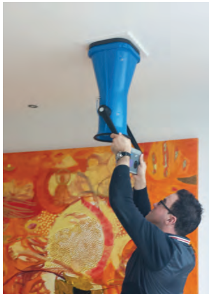
Bild 3: Mit Hilfe des Kompensationsverfahrens wird die Netzmessung an den Zu- und Abluftventilen vorgenommen. Bild: Airflow Lufttechnik GmbH
