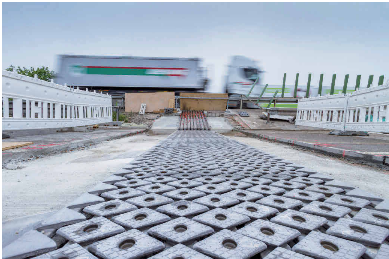
Die neuen Fugen der Rheinbrücke Baerl sind geräuschgedämmt. Abb.: MAURER
