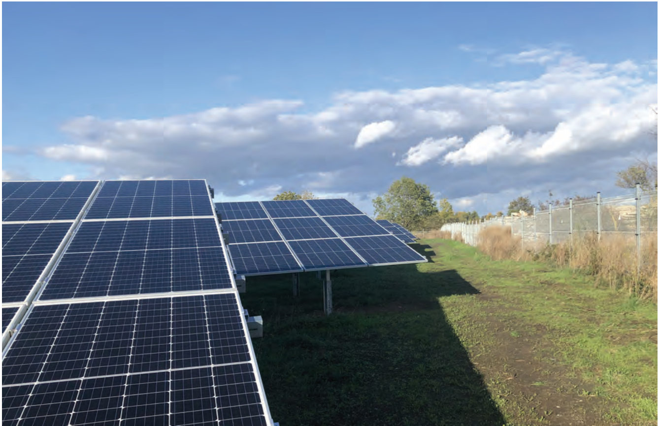
Blick auf die von enyway für die Anteilseigner errichtete Photovoltaik (PV)-Anlage in der Nähe der Stadt Hecklingen in Sachsen-Anhalt. Bild: enyway
