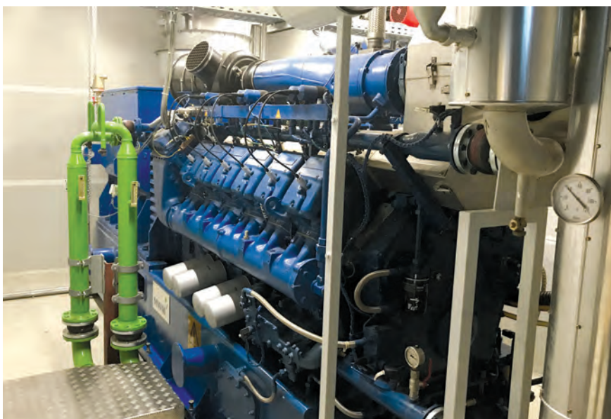
Mit der Inbetriebnahme des BHKW spart die Hauni Maschinenbau GmbH aus Hamburg knapp ein Viertel ihrer Energiekosten ein. Bild: Hauni Maschinenbau
