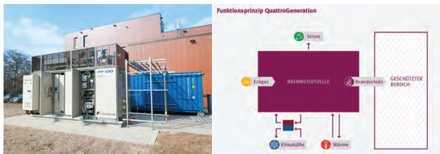
Bild 5 QuattroGeneration-Anlage am Zentrum für Brennstoffzellentechnik GmbH (ZBT) in Duisburg (links) und Funktionsprinzip der QuattroGeneration-Anlage (rechts). Bild links: ZBT, Bild rechts: Fuji N2telligence
