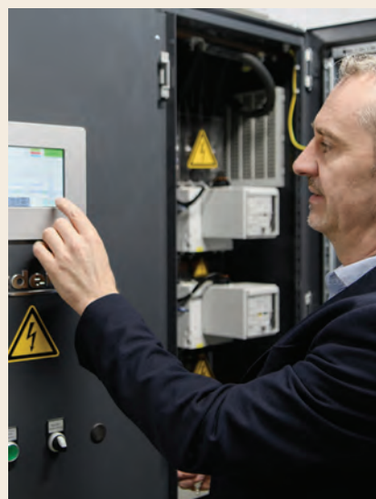
Hans Bretz vom Bauträger und Anlagenbetreiber LKW Kitzingen hat alle Einstellungen des BHKW jederzeit über den Farb-Touchscreen der Modulsteuerung im Blick. Bild: Buderus
