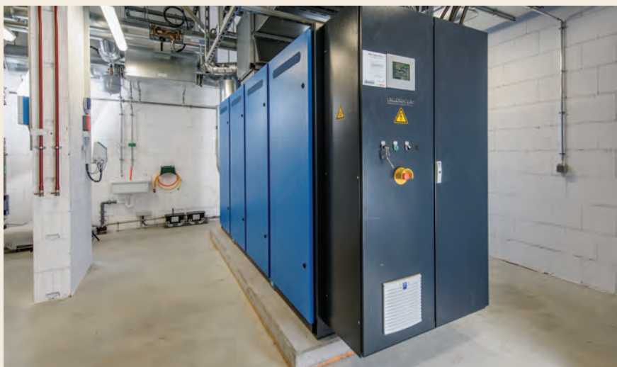
Dank Kraft-Wärme-Kopplung spart das Blockheizkraftwerk bis zu 40 % Primärenergie im Vergleich zur herkömmlichen getrennten Energieerzeugung. Bild: Buderus
