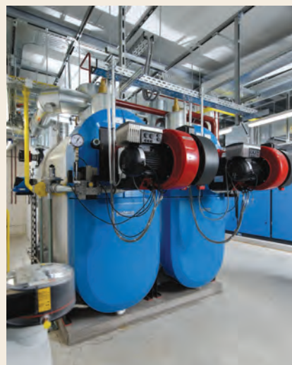
Zwei Gas-Brennwertkessel ergänzen das BHKW, um Spitzenleistungen abzufangen. Bild: Buderus
