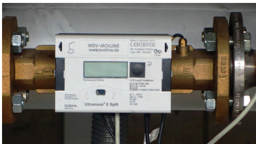
Wärmezähler , mit dem der Contractor die gelieferte Wärmemenge feststellen und den belieferten Firmen berechnen kann. Bild: König
