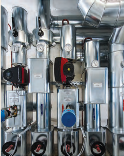
Über ein Nahwärmenetz wird die zentral erzeugte Wärme an die einzelnen Gebäude verteilt. Bild: Buderus
