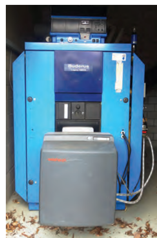
Für Redundanz und Spitzenlast ist ein Ölkessel mit 240 kW installiert, versorgt aus einem schon vorhandenen Heizöllager. Bild: König
